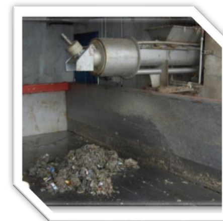
Refus de dégrillage - STEP principale de Limoges
