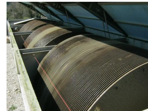
La station d'épuration Les Farges - Le Vigen (Disques biologiques - 300 équivalent-habitants)
