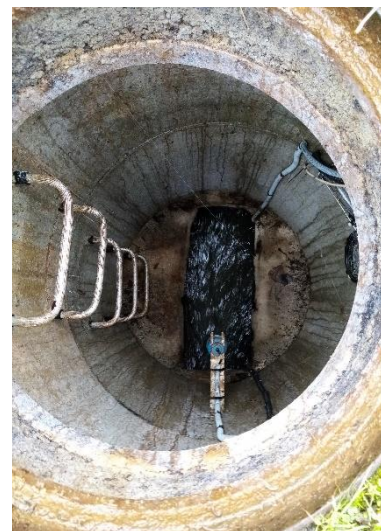
Débitmètre Hauteur / vitesse – STEP Rive Gauche
