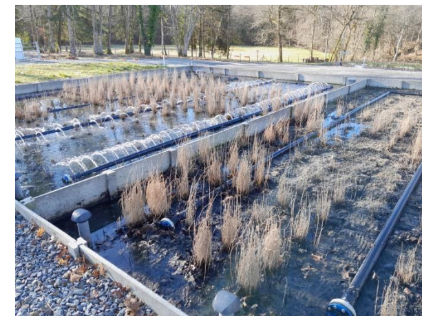
La station d'épuration du Petit Couzeix - Feytiat (Lit bactérien - 270 équivalent-habitants)
