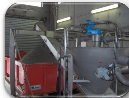
Lavage des sables dans la station d'épuration principale de Limoges.
