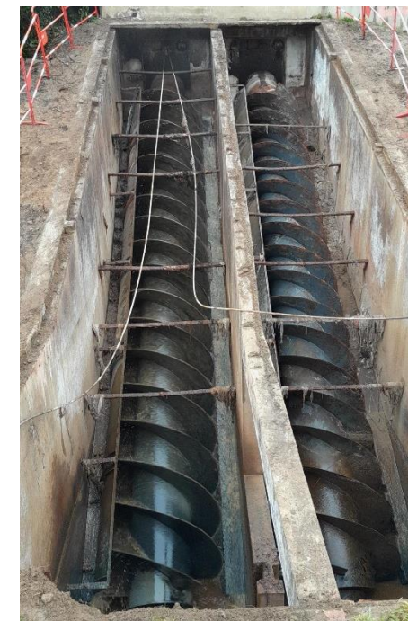
Vis de relevage du Pont St-Etienne - Limoges
